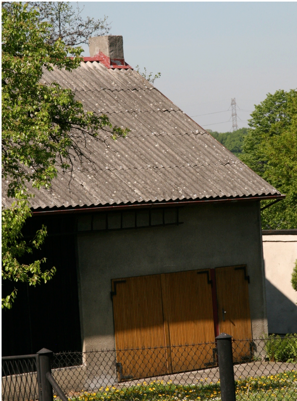
Rysunek 3 Dach pokryty płytami azbestowymi falistymi
